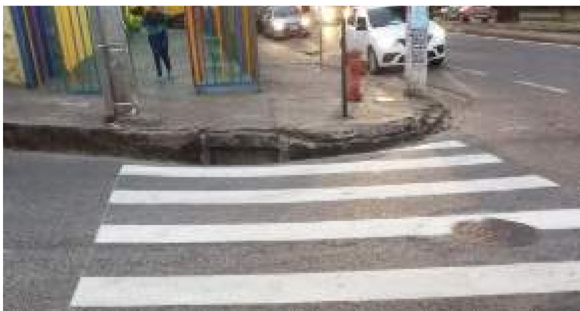
Revitalização da sinalização horizontal nas Ruas Santa Maria Goretti e São Domingos, próximas ao Colégio Santa Rita
